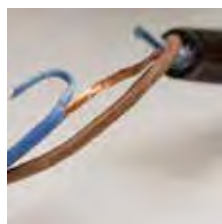
Frayed Wire Cable desgastado
